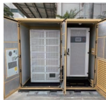
非洲塞拉利昂微电网项目
