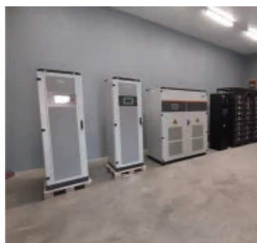
多米尼加微电网项目
